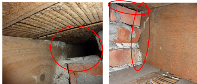
Naden en kieren tussen metselwerken de balklaag
