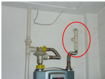
Gasmeter in de gezamenlijke verkeersruimte
