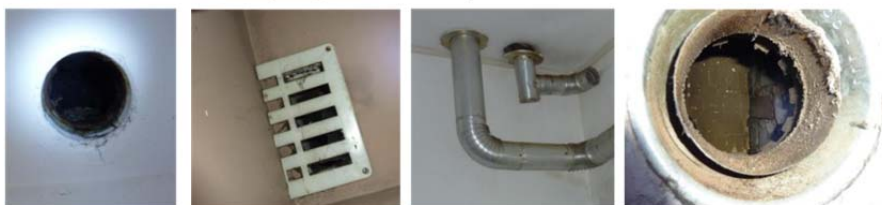
Diverse ventilatieafvoer en rookgasafvoeren aangesloten op schachten niet brandwerend uitgevoerd
