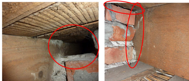
Naden en kieren tussen metselwerken en de balklaag
