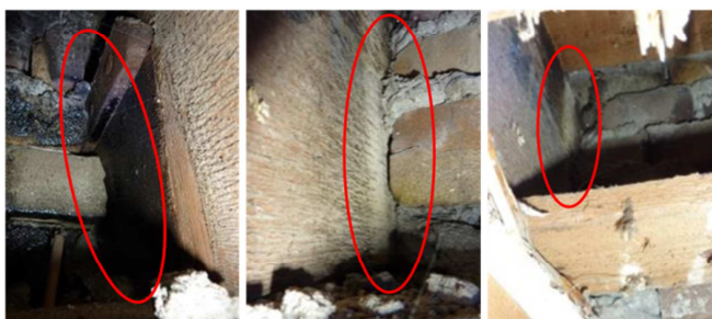
Naden en kieren tussen metselwerken en de balklaag
