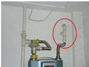
Gasmeter in de gezamenlijke verkeersruimte
